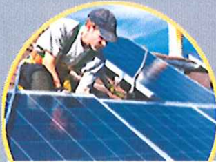
Instalador/ra de placas solares
